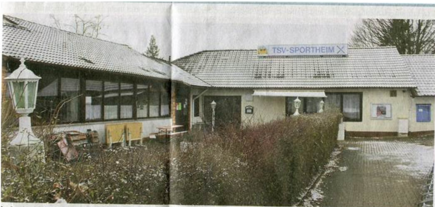
Das Sporthaus des TSV Höchst ist so marode, dass wohl nur ein Abriss eine sinnvolle Lösung wäre. Die Stadt hat dafür kaum Verwendung.
